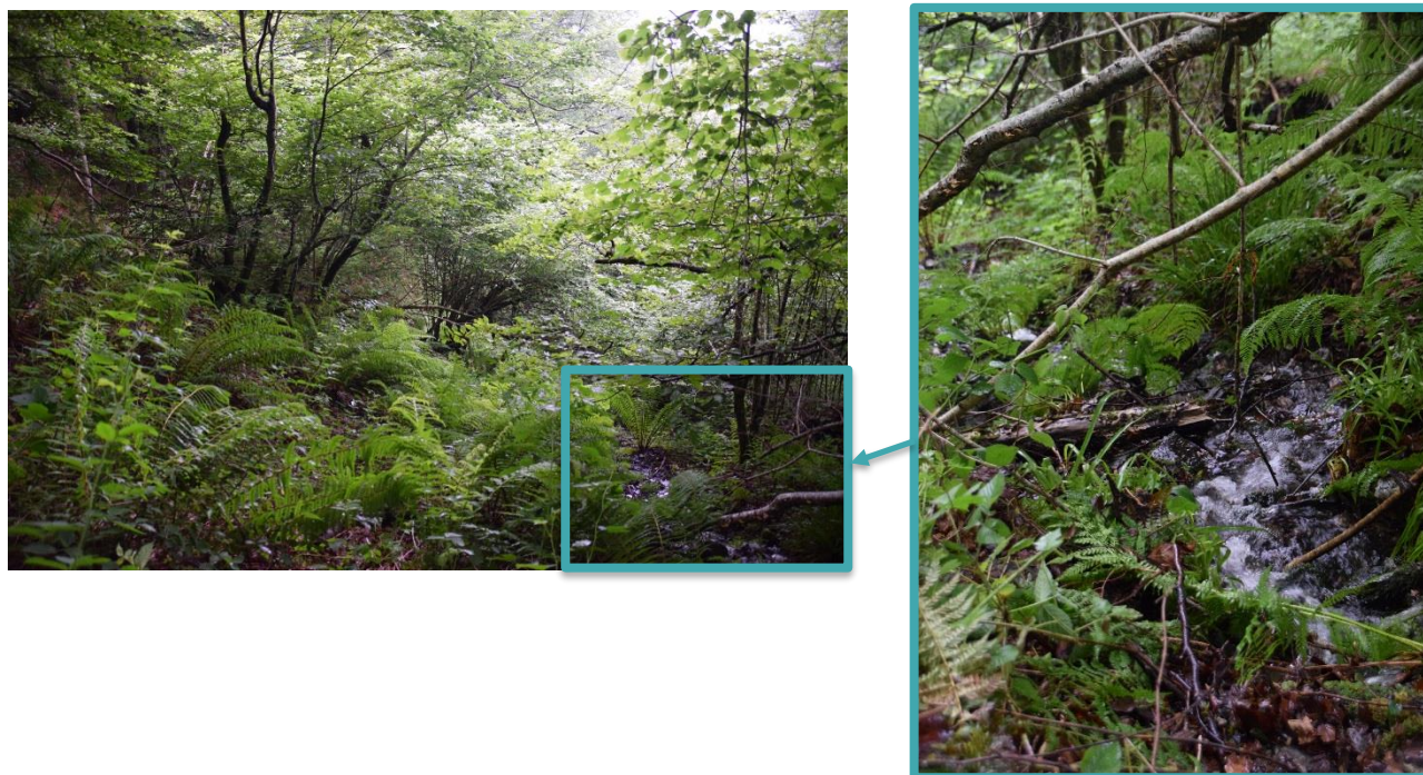
Illustration 23 : Clichés de la sortie de trop-plein au pied de l'ouvrage de captage et ruissellement dans le talus naturel sous couvert forestier
